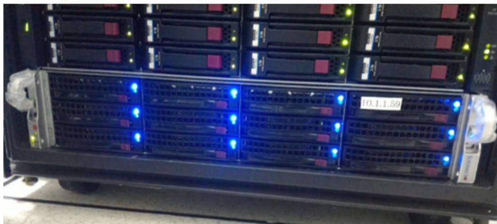
圖 2-4 儲存設備架設於內政部機房
